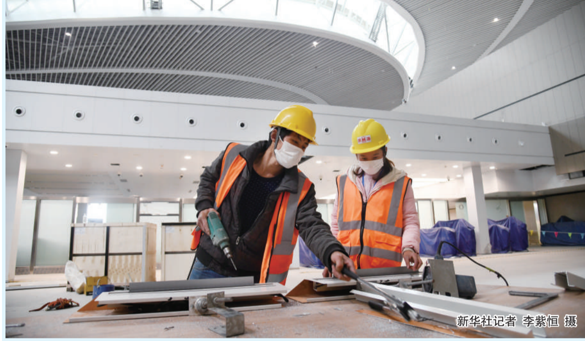
3月25日,两名工人在青岛胶东国际机场航站楼中央景观区施工。近日,青岛胶东国际机场项目全面复工。截至目前,机场飞行区、货运区完成竣工验收,进出港主流程具备演练条件,整个工程已到了“收尾冲刺”阶段。
